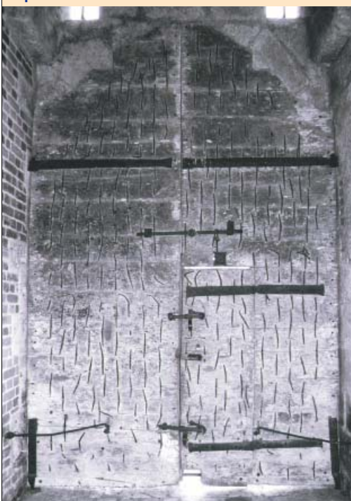
2. Contre-parement des vantaux du château du Moulin ; les clous traversant les deux épaisseurs de planches ont des pointes bifides très longues et rabattues. Les ferrures assurant la rotation sont à pentures en haut et à pivot sur crapaudine en bas.
