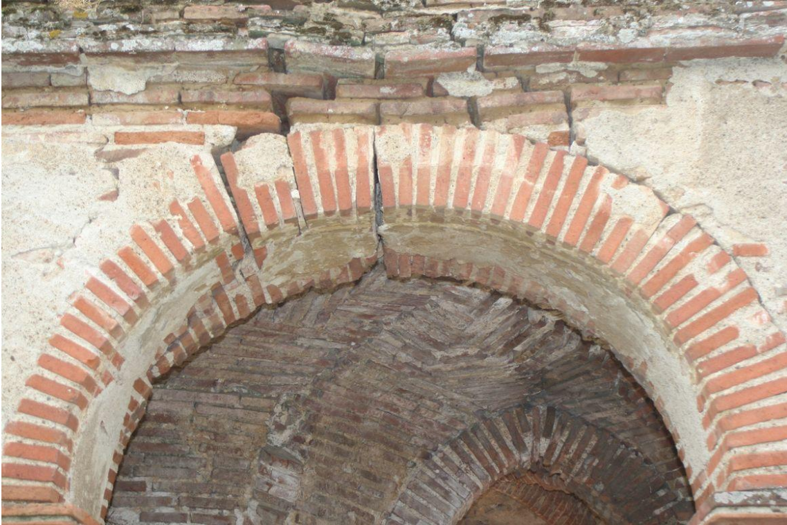
Le poids de l'ensemble a fait plier la ceinture en brique provoquant la fissure de l'arcade.
